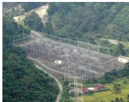
タンガ発電所 (P=22.3MW) の地上の変電所、 1982年完成
