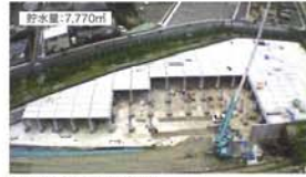
常永2号貯水槽 (山梨県) プレキャストPC製地下貯水槽 貯水量: 7,770㎡
