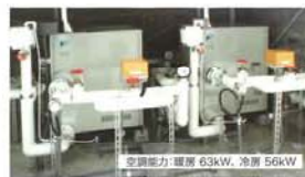
南砺市役所 福野行政センター (富山県) 地中熱ヒートポンプ空調システム 空調能力: 暖房 63kW, 冷房 56kW
