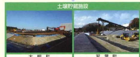
■分別後の除去土壌等を放射能濃度別に貯蔵しています。
