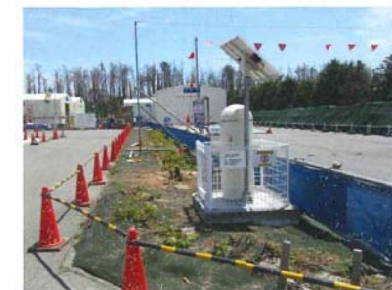
【保管場におけるモニタリング装置】
