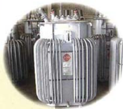
■PCB廃棄物となったトランス
