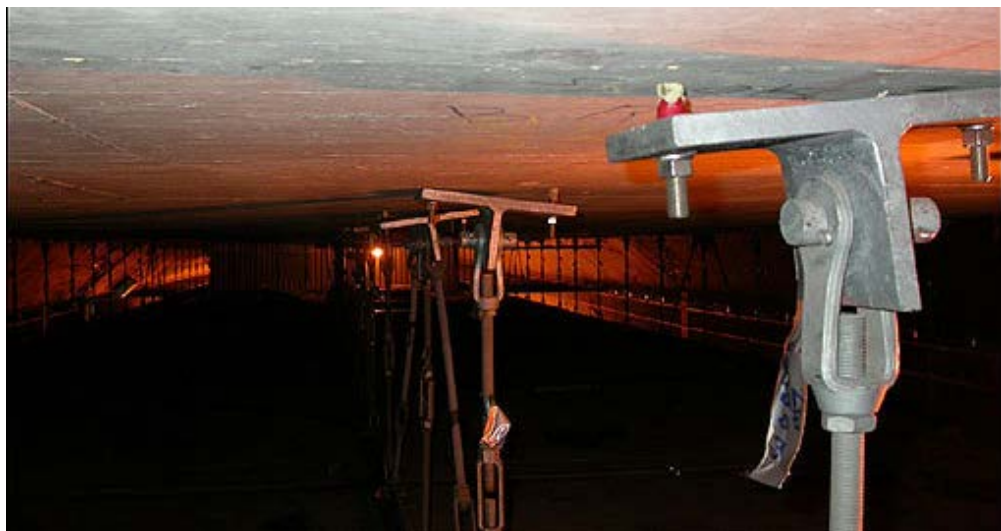
図9 天井版アンカーの施工不良 10)
