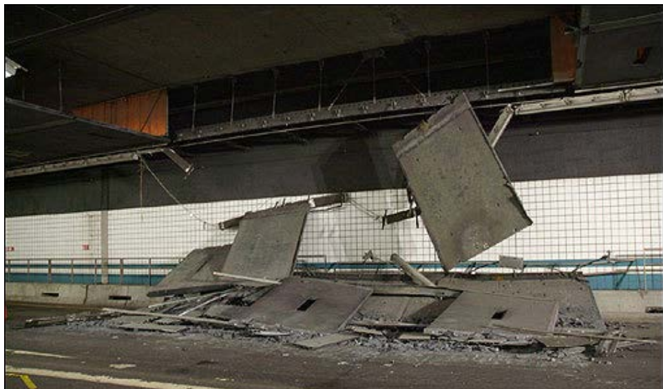
図8 ポストン市内トンネル天井板崩落事故 10)
