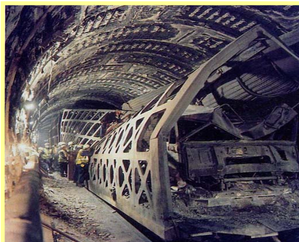
図11 火災による躯体損傷 5)
