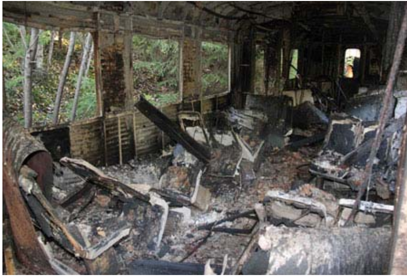
図 17 火災後の内部 7)
