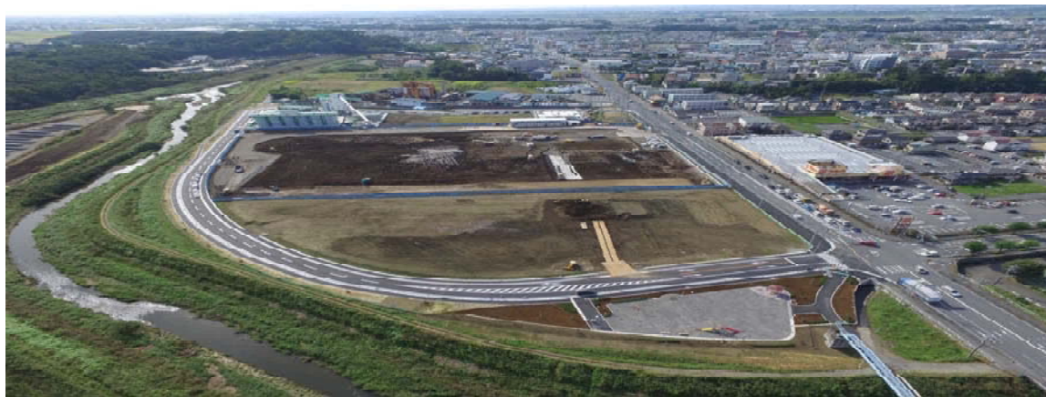
東松山市都市計画事業 藤曲土地区画整理事業造成工事
