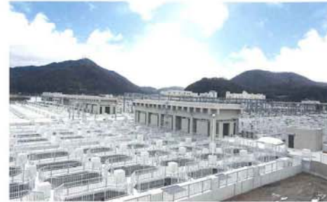
児島湖流域下水道浄化センター(岡山県玉野市)
