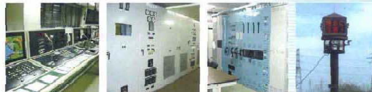
ダム総合管理事務所操作室
