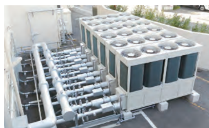
空調機室外機
