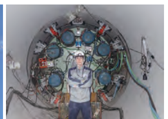
トンネル掘削機内部
